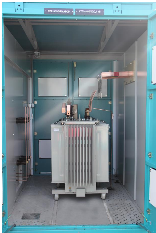
Рисунок 8 Отсек силового трансформатора
