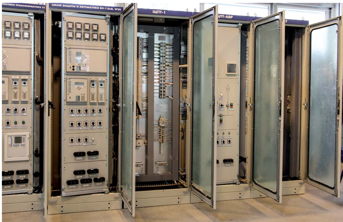
ШКАФЫ РЕЛЕЙНОЙ ЗАЩИТЫ И АВТОМАТИКИ типа ШРЗА-КЕМ/kz
